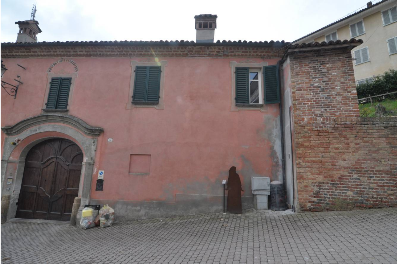
ZOCCOLO DI INTONACO IN RILIEVO
