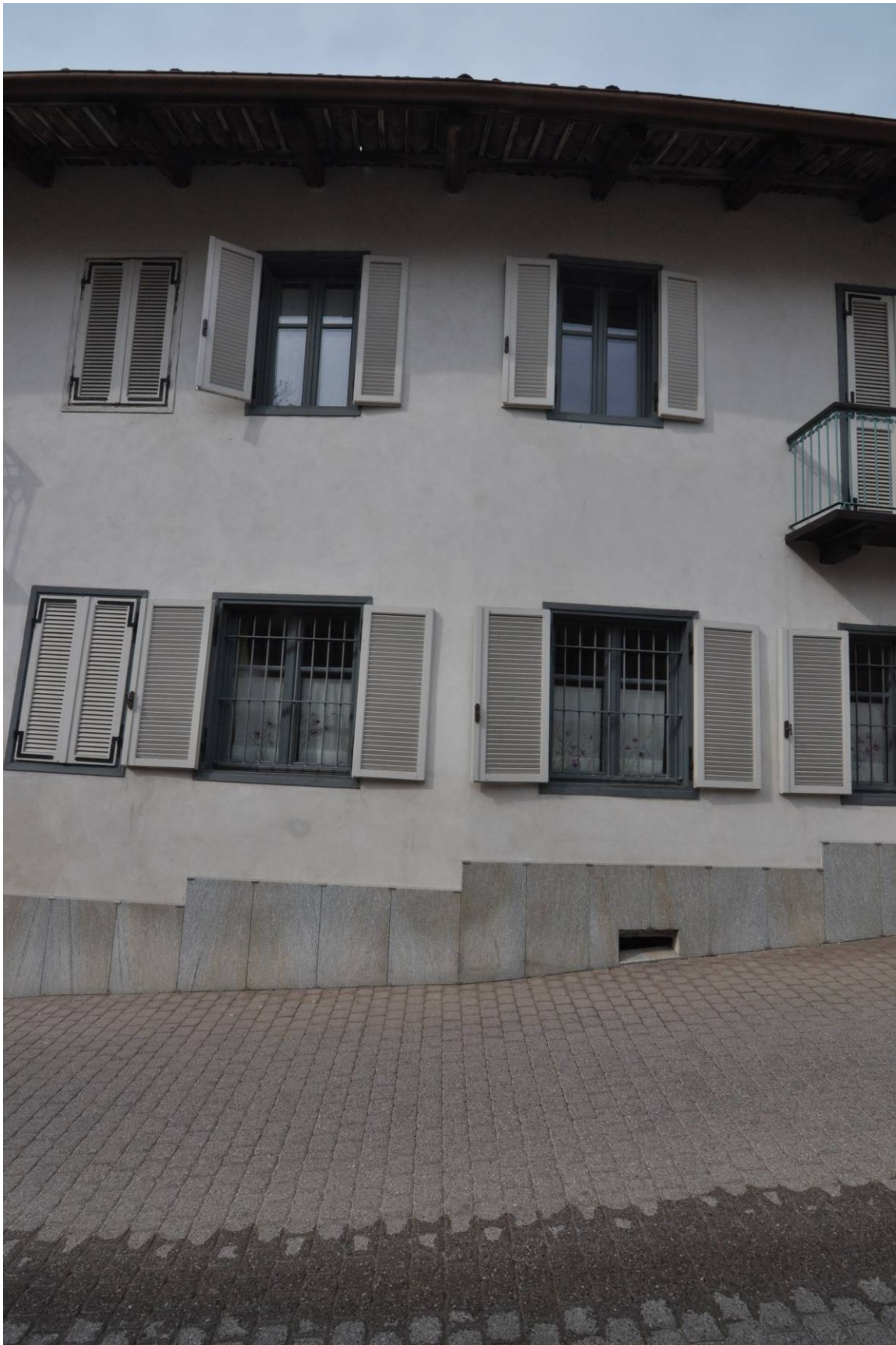
POSIZIONE CORRETTA DELLO ZOCCOLO IN PIETRA, DISTACCATO DAL SUPPORTO TRAMITE STAFFE IN FERRO
