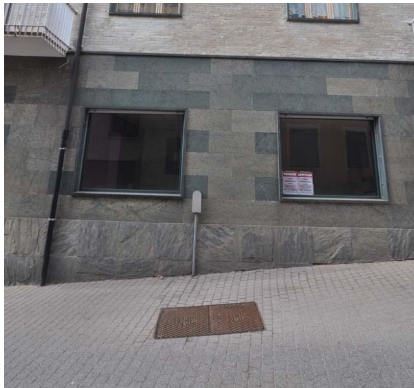
RIVESTIMENTO IMPROPRIO DI FACCIATA
